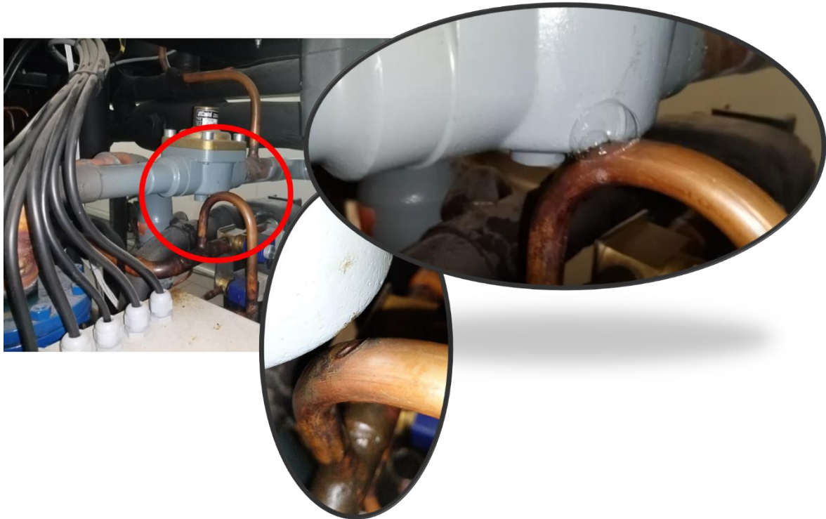
Figura 5. Localización de la fuga de gas en la cámara Fitoclíma 8000 ECP50.
